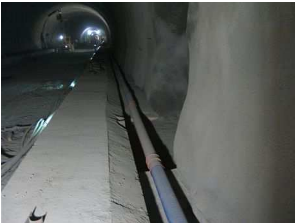
Cholupický tunel - Potrubí boční tunelové drenáže
