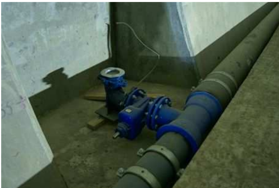
Cholupický tunel - Potrubí požárního vodovodu s odbočkou k hydrantu
