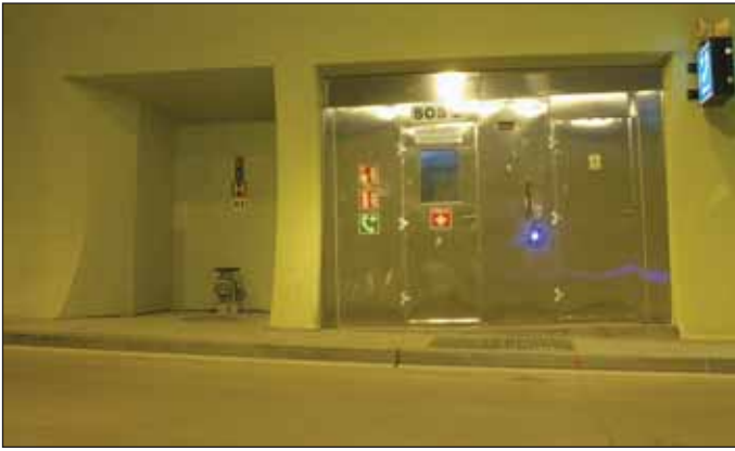
Obr. 8 Sdružený výklenek požárního hydrantu a skříně SOS Fig. 8 An SOS niche with a fire hydrant
