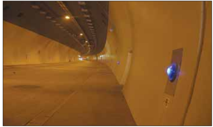
Obr. 9 Nouzové osvětlení a další vybavení tunelu Fig. 9 Emergency lighting and other tunnel equipment
