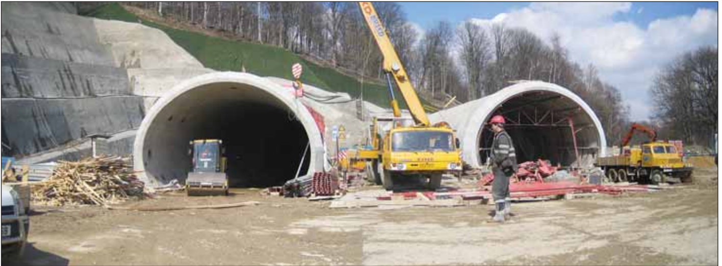
Obr. 4 Hloubené tunely na jižním portále Fig. 4 Cut-and-cover tunnels at the southern portal
