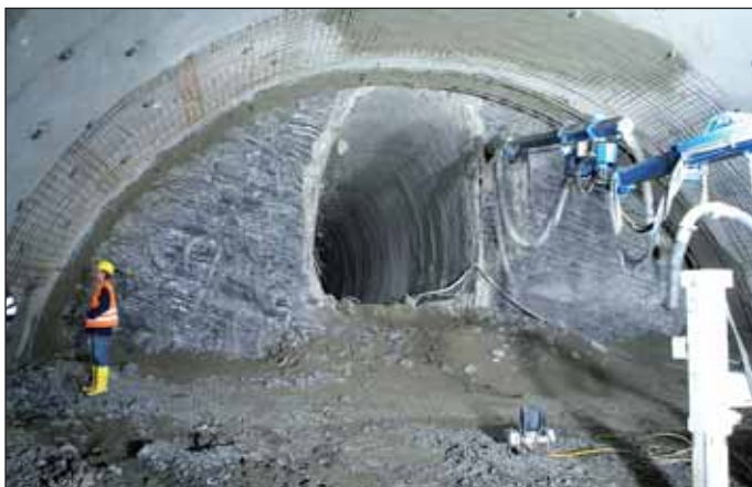
Obr. 1 Průzkumná štola situovaná ve středu kaloty jižního tunelu Fig. 1 The exploration gallery found in the centre of the southern tunnel calotte
