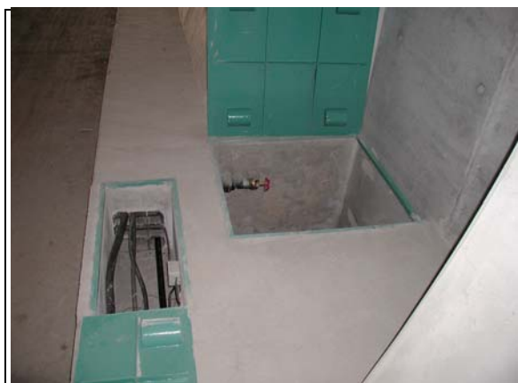
Obr. 6.5 – Kabelová šachta a šachta na čištění drenáže s napojením požárního vodovodu
