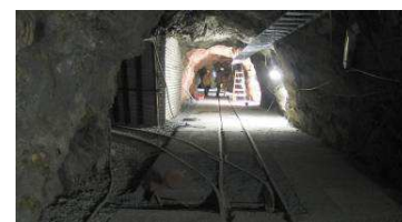
Lávky pro kabely a osvětlení, v popředí nová výhybka. Current state, bridge for electrical equipment on the right up, new rail switch in the foreground.
