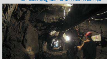
Flexibilní luty separátního větrání pracoviště v západní části ložiska Čelina. Flexible ventilation pipes.
