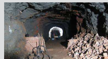
Bourání zdi, která zabraňovala vstupu do podzemí. Demolition of old fixtures and fittings.
